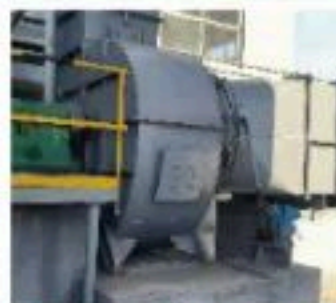
润锦化工尿素除尘风机
