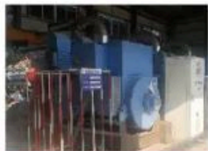
锦富煤业高浓度瓦斯发电设备
